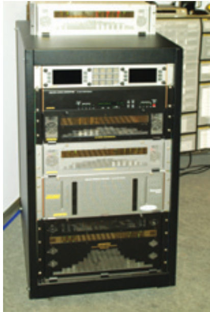
Стойка с оборудованием Evertz
